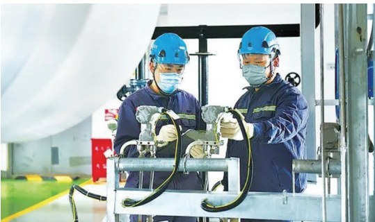
山东海阳核电站“暖核一号”项目运行工程师正在对设备进行巡检。
