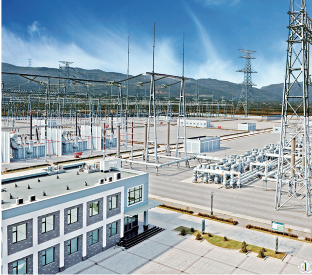
图①为日月山750千伏变电站 图片来源网络
