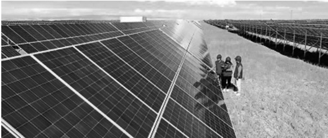
国家电网青海电力三江源共产党员服务队在青海海南共和光伏产业园做好电力服务保障工作
