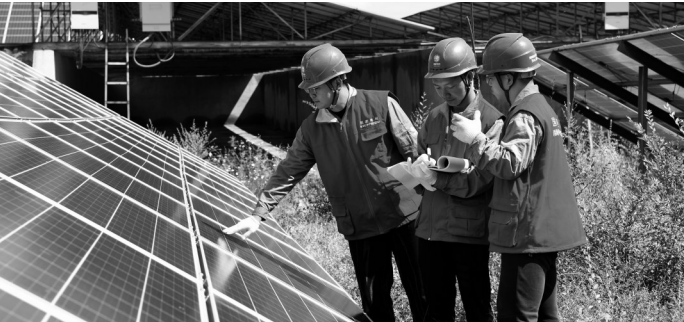
国网海东供电公司员工在白家村巡检光伏电站的发电设备 李永鹏 摄
