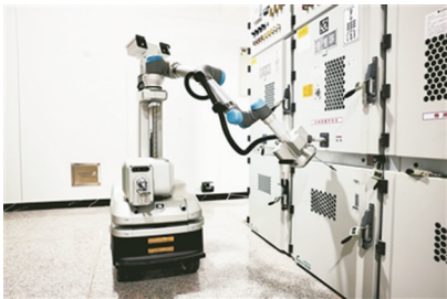
智能操作机器人在110千伏天宁变电站进行倒闸操作
