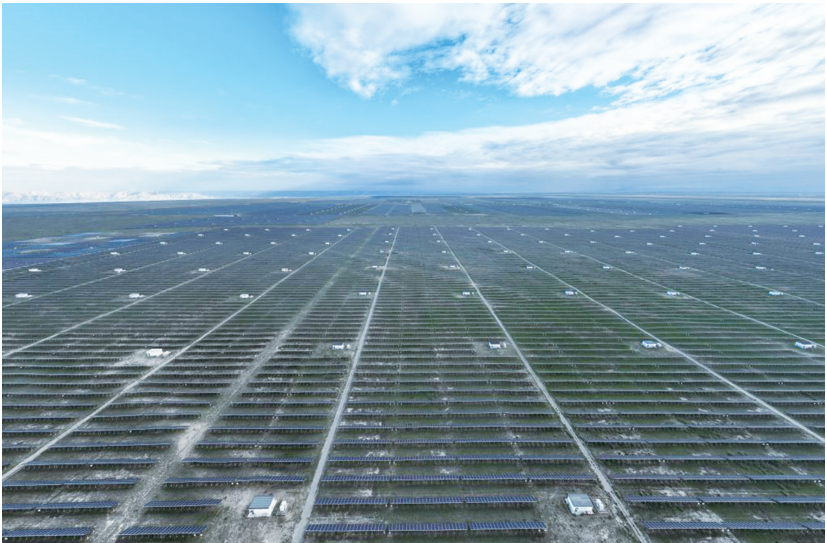
图为海南藏族自治州共和县的光伏电站
